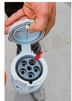
Für die Hauseinspeisung vorgeschrieben: Steckverbindungen mit dem Schutzleiter auf 1 Uhr.
