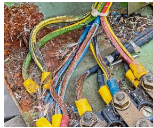
Noch rechtzeitig: Dieser Kabelschaden wurde bei einem Probelauf festgestellt.
