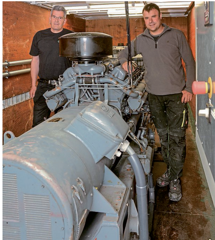
Nach der Modernisierung durch Werner Gelking (links) versorgt die 120-kVA-Ersatzstromeinheit im Notfall zwei Hähnchenställe, einen Mastschweinestall, eine Biogasanlage und das Wohnhaus von Betriebsleiter Christian Herweg (rechts).
