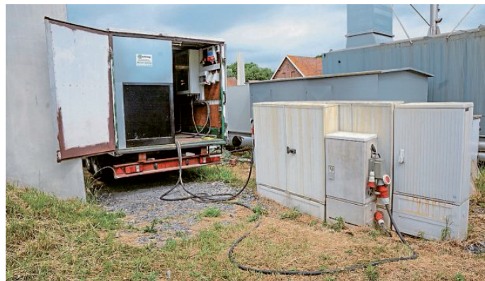
Der Stromerzeuger ist in einem Lkw-Anhänger untergebracht und steht direkt neben den Einspeisepunkten für die Notstromversorgung.
